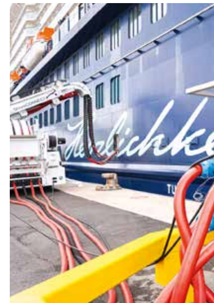
Landstromanschluss im Hafen mit einem „Grüner-Strom-Konzept“.
